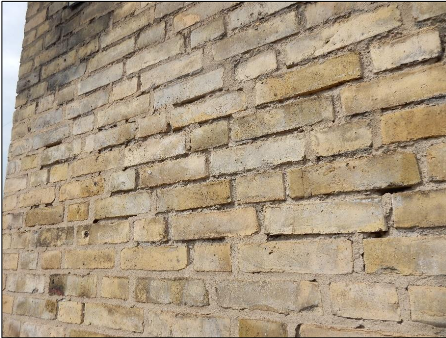
Fasad med fukt- och frostsador
