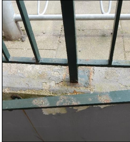
Skador på räcke och källartrappa
